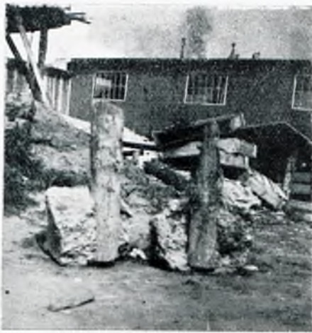
Rys. 1. Pale po rozbiciu betonu: a) na lewo — zabetonowany dobrze; b) na prawo — zabetonowany z dostępem z góry powietrza i wody.
