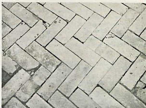
Rys. 2. Nawierzchnia klinkierowa na zaprawie cementowej — po uwalowaniu, lecz przed zalaniem spoin zaprawą. Wyraźnie widać 4 poważnie zgruchotane klinkiery. Poza tym widać jeszcze cały szereg odprysków na poszczególnych klinkierach — rezultat walcowania ciężkim walcem.
