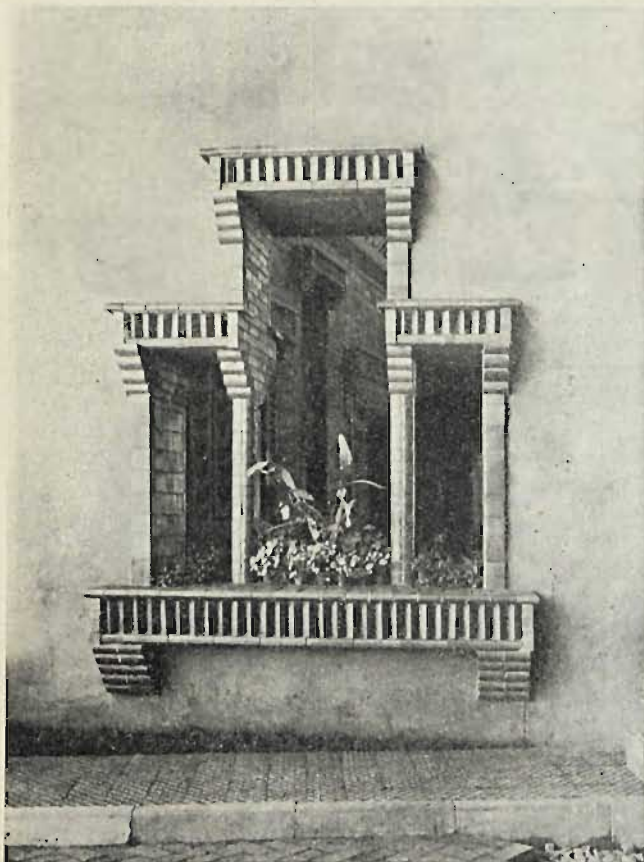
Rys. 2. Widok trzyskrzydłowego okna, obłożonego klinkierem okładzinowym w kolorze srebrzysto - błękitno - szarym z Przysieki.
