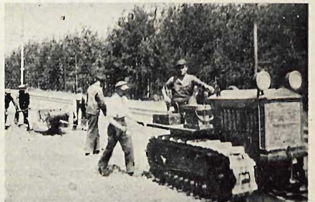
Rys. 2. Zrywanie starej szutrówki na drodze Piotrków — Łódź. Las i kolejka elektryczna nie pozwala na urządzenie objazdu poza rowem.
