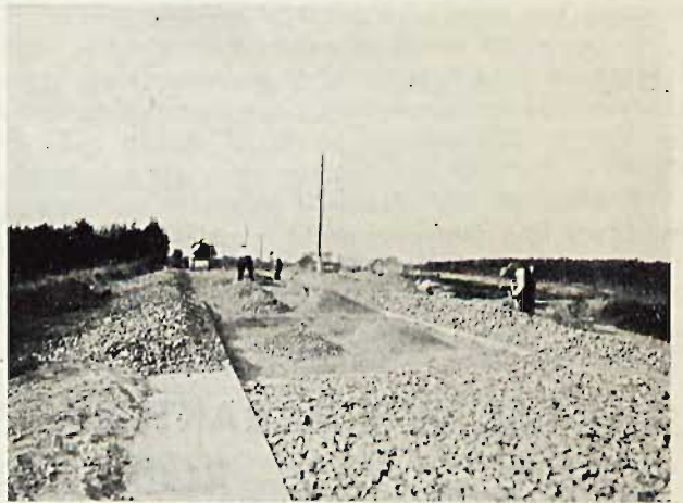
Rys. 1. Wykonywanie podbudowy na drodze Lubochnia — Piotrków. Brak miejsca na objazd dla ruchu publicznego.
