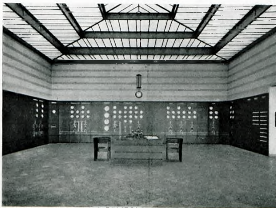
Rys. 3. Nastawnia przetrwórnicy Chorzów.
