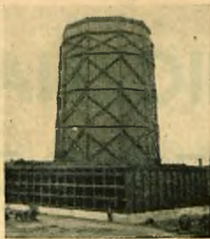
Chłodnia na 2000 m 3 /godz. dla Elektrowni Okr. w Częstochowie.
