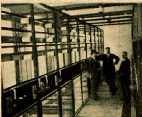
Szyny zbiorcze i napędy odłączników trójbiegun.
