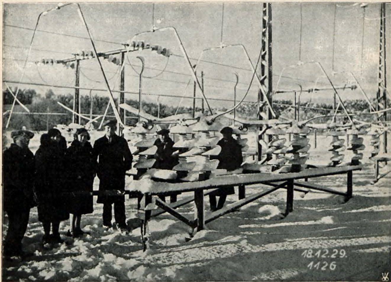
Rys. 26. Odłączniki 60 000-woltowe, zdolne do przerywania większego prądu. Konstrukcja i wyrób „Gródka”.
