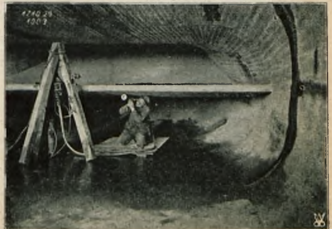
Rys 21. Wylot ssaka. Wyglądanie betonu.
