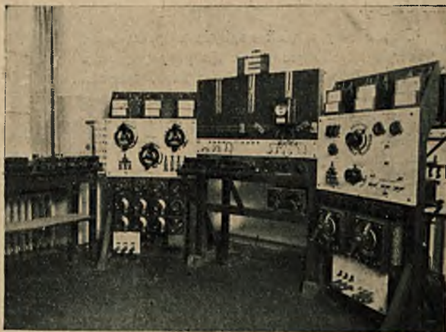
Rys. 12. Duża tablica rozdzielcza prądu trójfazowego.
