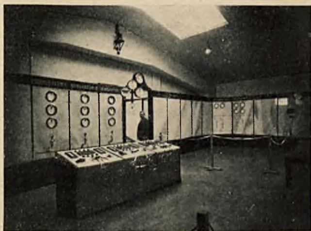
Rozdzielnia elektrowni Zagłębia Krośnieńskiego w Brzeźowce.
