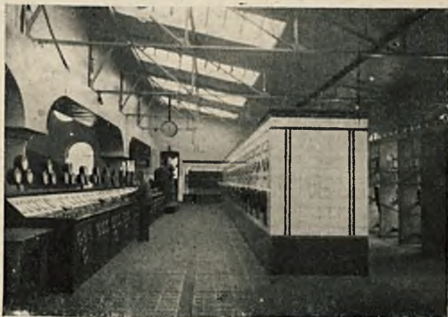
Rozdzielnia w Hucie Pokoju.
