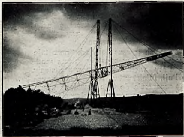
Rys. 22. Unoszenie słupa o długości 54 m i wadze 20 t. Skrzyżowanie Wisły, 7 km poniżej Chełmna, 1924.
