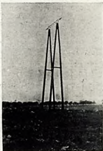
Rys. 21. Portalowy słup odporowy, składający się z 2 słupów rozkracznych po 18 m długości. Odległość międzyprzewodowa 2 \times 3,5 m. Prześia 250 (maks. 280) m. Linja Głódek — Gdynia, 1928.
