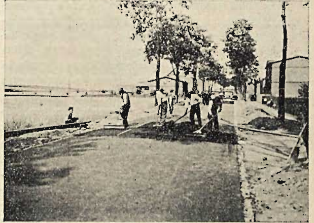
Dywanik smołogranitowy w trakcie wykonania na drodze wojewódzkiej Tarn. Góry — granica. (Widoczne wszystkie 3 warstwy).
