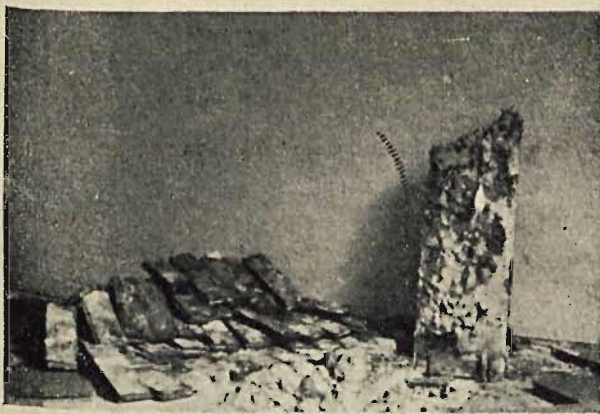
Rys. 17. Odkrywka opianowanej przez grzyb podłogi parkietowej w jednym z domów w Warszawie. (Ze zbiorów firmy FUNGUS).
