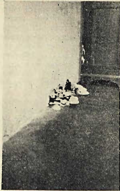
Rys. 15. Owocniki grzyba MERULIUS LACRYMANS wystające przy ścianie murowanej. Grzyb przeszedł na szafy i opanował księgozbiór. (Ze zbiorów firmy FUNGUS).
