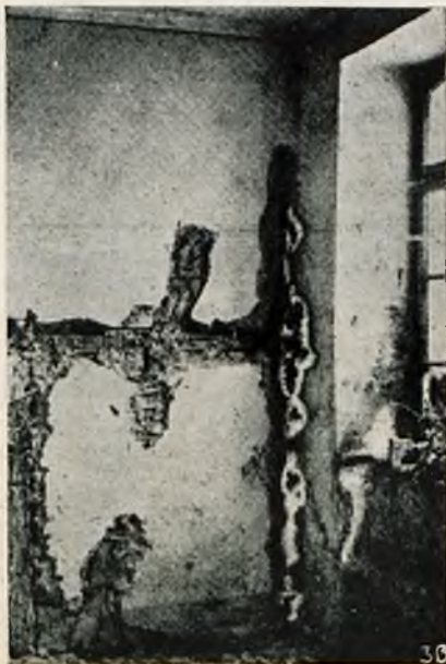
Rys. 5. Tak zwany pruski mur zniszczony przez grzyb „merulius lacrymans”. (W/g F. Kallenbacha).
