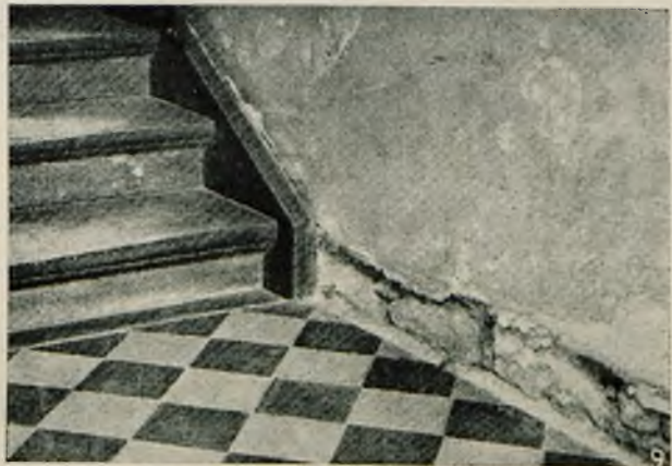
Rys. 8. Zniszczenie częściowej ściany murowanej przez grzybnię „ merulius lacrymans ”. (Wyżej widoczne plamy grzybowe na ścianie). (W/g F. Kallenbacha).
