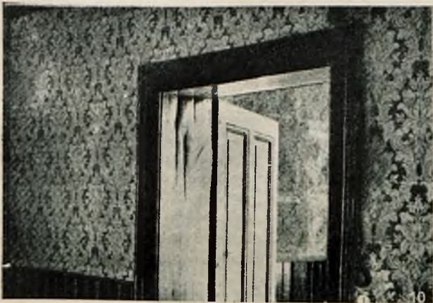
Rys. 7. Charakterystyczne zniszczenie futryn drzwiowych przez grzyb „ merulius lacrymans ”. (W/g F. Kallenbacha).
