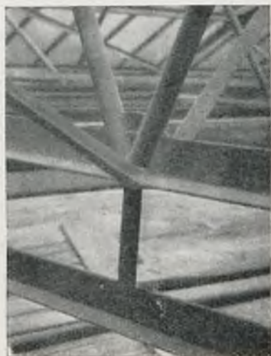
Rys. 10. Węzeł dolny dachu. Między rurami wstawka dla wydłużenia szwu wewnętrznego (zasada symetrii szwu). Dołem podwieszenie witrażu.
