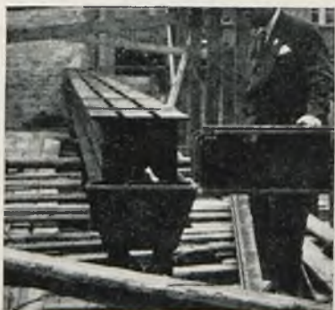
Rys. 19. Podciąg zbiegający się do czola „przycięte do spojenia”
