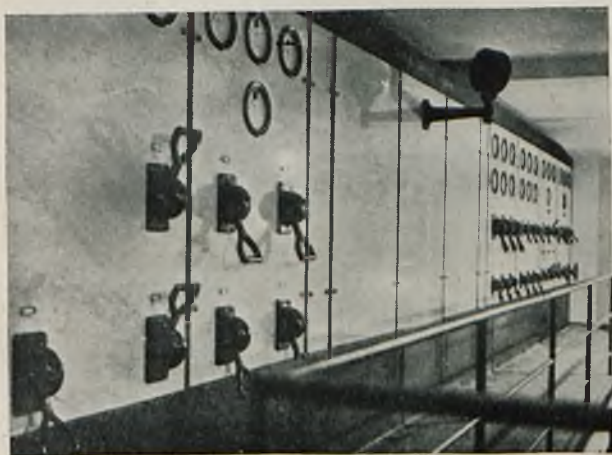
Rys. 4. Tablice rozdzielcze prądów silnych z aparata dla własnej elektrowni.
