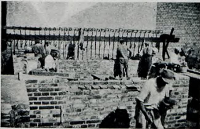
Uzbrojona ściana szczytowa, nadwieszona nad odsadzkami sąsiada.
