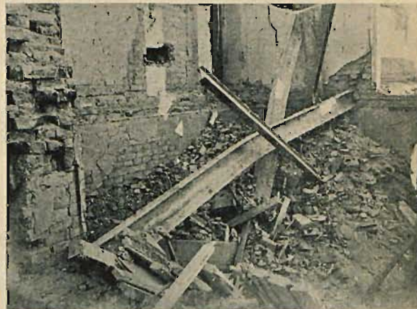
Rys. 9. Belka z nad piwnicy. Wygięcie ku górze 4 cm., odgięcie 18 cm.
