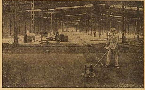
Wykonywanie podłogi przy pomocy maszyny „Pretonia” w fabryce f-my „Polskie Fabryki Kabli i Walcowni Miedzi S. A.” w Ożarowie p. Warszawą.
