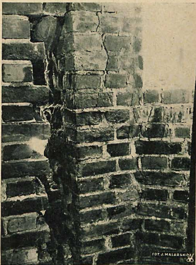
Pęknięcia na filarach klatki schodowej po katastrofie.
