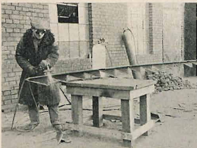
Fig. 15. Przecinanie palnikiem acetylenowo-tlenowym teownika na trójkątowe części, stosowane następnie w szczególności jak na fig. 14.
