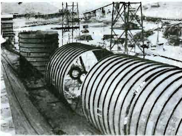
Rys. 9. Rury stalowe do sztolni obiegowej.
