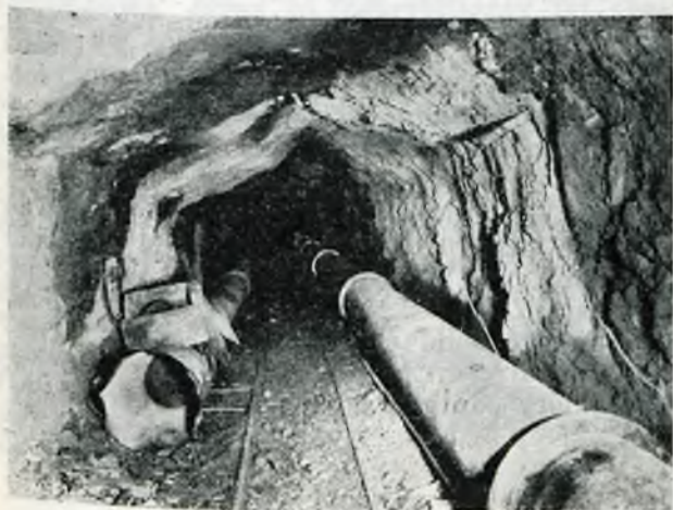
Rys. 12. Przewody wentylacyjne w sztolni.
