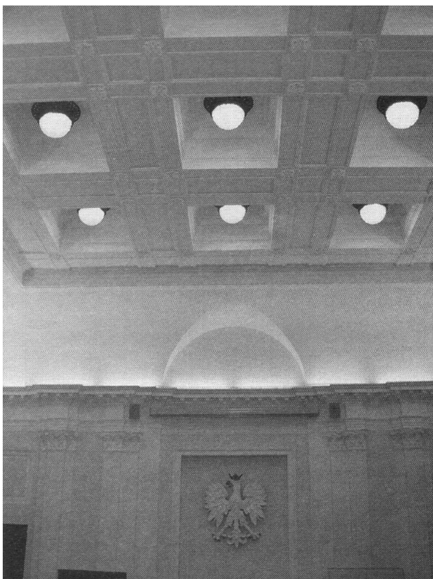
System kasetonowy utworzony w Małej Auli przez kanały wentylacyjne
