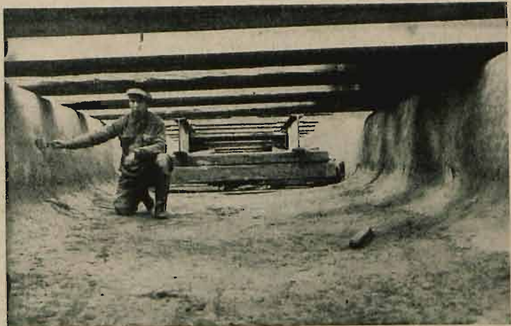
Fig. 5. Wyprawa wewnętrznych ścian murów parapetowych w części, gdzie usunięto urządzenie tymczasowe z dźwigarów żelaznych i ułożono belki na murach parapetowych: na dalszym planie widać nie usunięty jeszcze urządzenie dźwigarowy.
