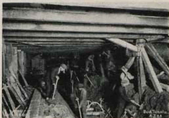
Fot. z dn. 4.X.1928. Roboty ziemne pod konstrukcją odciażającą przy ul. Marszałkowskiej.
