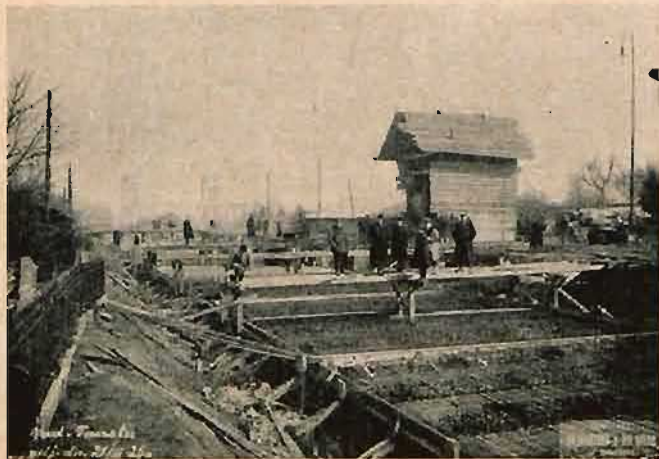
Fot. z dn. 21.III.1925. Widok zbrojenia i betonowania przy wykonaniu pokrycia tunelu na odcinku Smolna — N. Świat.
