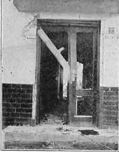
rys. 564. Drzwi złamane na wysokości klamki.
