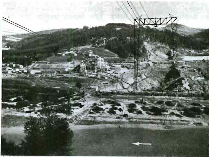
Rys. 5. Ogólny widok placu budowy — stan dn. 5.X.1936; na lewo zabudowania warsztatowe, w środku fabryka betonu, wyżej kolonia budynków stałych; wykop zamknięty ścianą Larsen'a.
