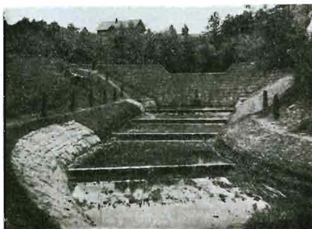
Rys. 11. Zapora z korekcją progową na debrze „A”, km 0+200. Łuk wklęsły ubezpieczony opaską kamienną.
