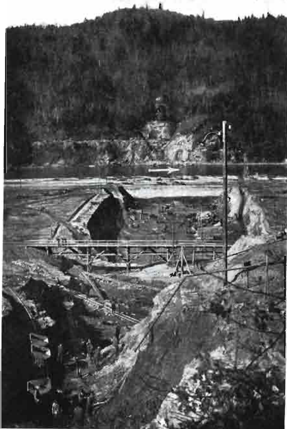
Rys. 4. Wykop fundamentowy — stan dn. 10.III.1936; na pierwszym planie most kolejki Marcinkowice - Rożnów.
