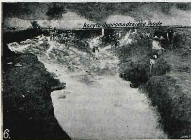
Rys. 6. Robotnicy wzruszają materiał ziemny i wrzucają w strumień wody, który unosi materiał na groble.
