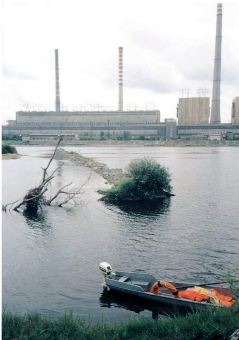
Rys. 2.7. Uszkodzona ostroga w rejonie Elektrowni Kozienice (fot. P. Kuźniar)
