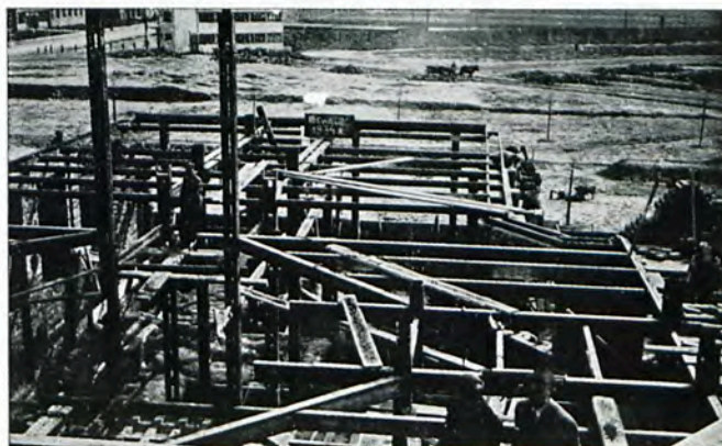
Fig. 549. Vue de l'ossature métallique, montrant les poutres obliques horizontales des galeries entourant la cage de l'escalier.
