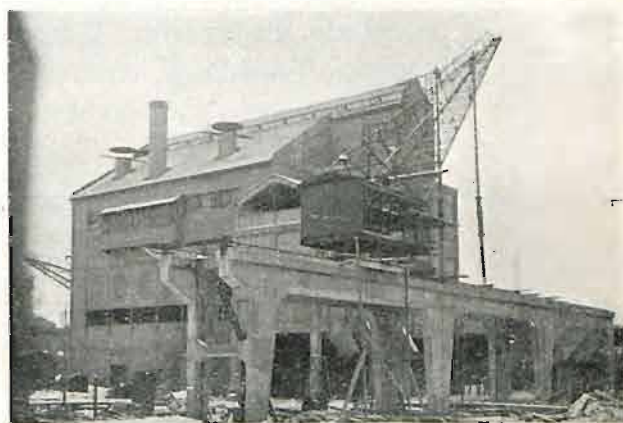
Budowa piecowi syst. Glover West w Gazowni Warszawskiej. Widok piecowi od strony pomostu dla żorawia koksowego.
