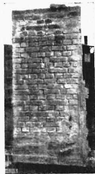
Rys. 17. Mur ceglany poddany działaniu 2-godz. ognia i następnie polany wodą.
