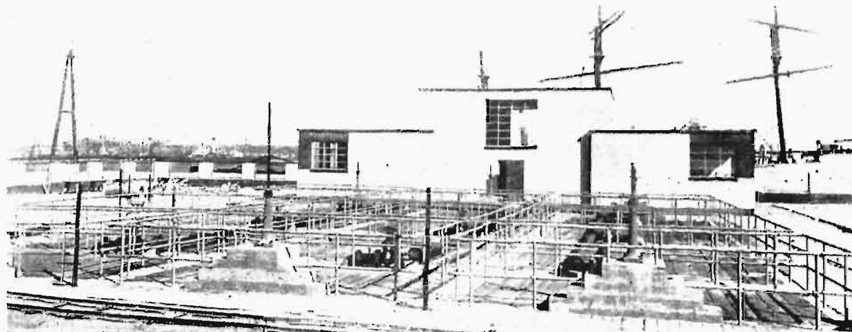
Rys. 15. Osadnik Imhoffa i stacja pomp.
