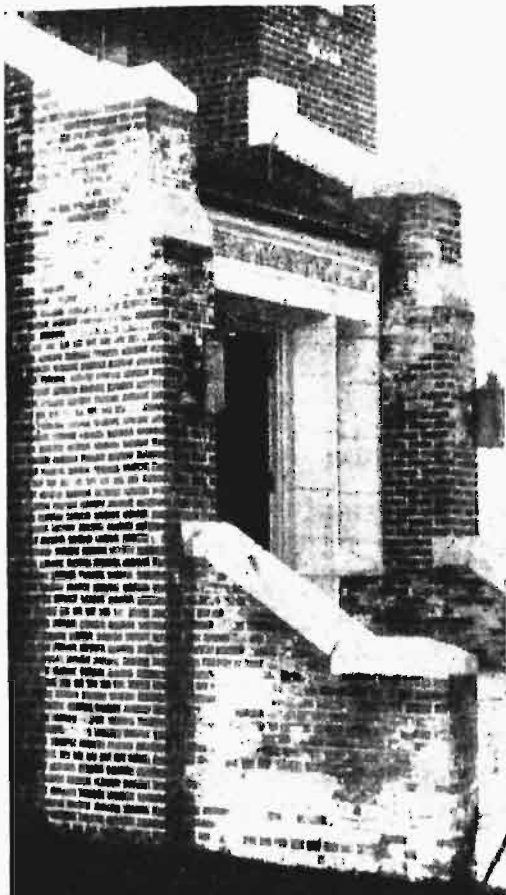
Rys. 2. Wykwity na murze ceglanym, wywołane przez złą zaprawę.
