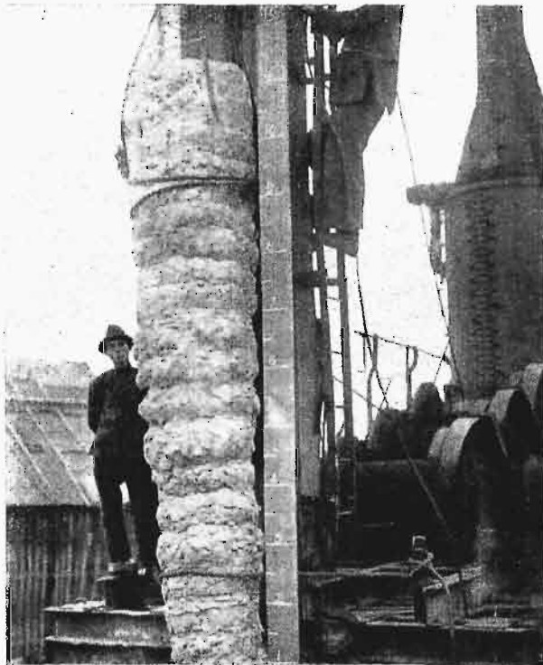
Rys. 4. Pal wyciągnięty z gruntu. Widoczne są charakterystyczne obręcze, odpowiadające kolejnym ubijaniom dawkom betonu.
