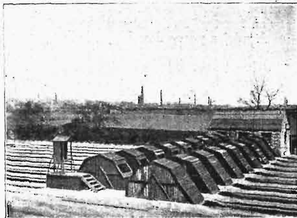
Rys. 8. Urządzenia Haworth'a z mieszadłami do przewietrzania ścieków.
