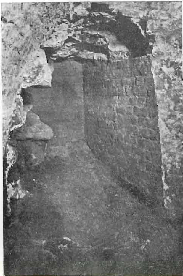
Zamek królewski w Warszawie. Epoka ks. Mazowieckich. Mur piwnicy pod salą o 2 słupach od strony Baszty Grodzkiej.
