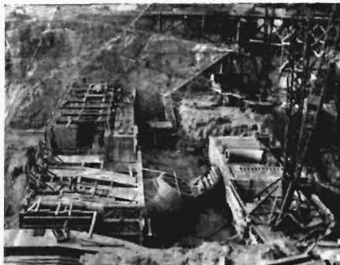
Rys. 30 Widok szalowania kanałów wylotowych z pod turbin. Widac rozdział kanału na 3 części.
