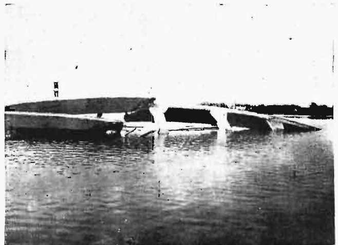
Rys. 2. Jedno z przęsła zniszczonych mostu.
