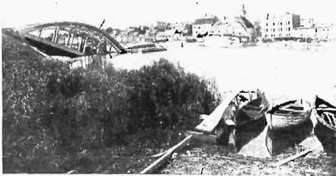
Rys. 1. Widok mostu po katastrofie.
