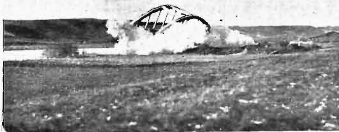
Rys. 4. Zniszczenie przęsła ocalalego, wobec niemożliwości zużytkowania go w innym miejscu.
