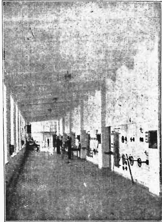
Rys. 8. Hala obsługi instalacji konwersji gazu wodnego.
