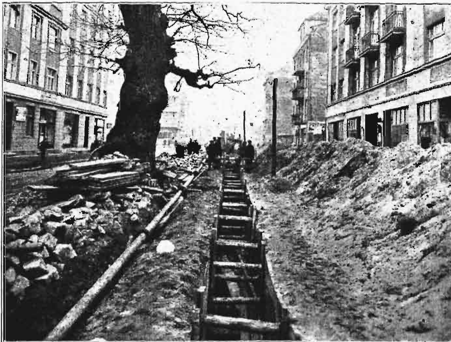
Rys. 8. Budowa kanału sanitarnego w ul. Portowej obok Dębu historycznego. Równoległe do wykopu — ciąg ssący do studzien obniżających wody gruntowe.
