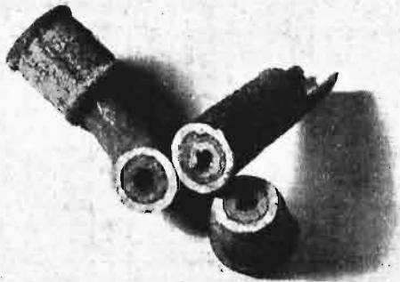
Rys. 2. Rury wodociągowe, zarośnięte osadem węglanowym.
