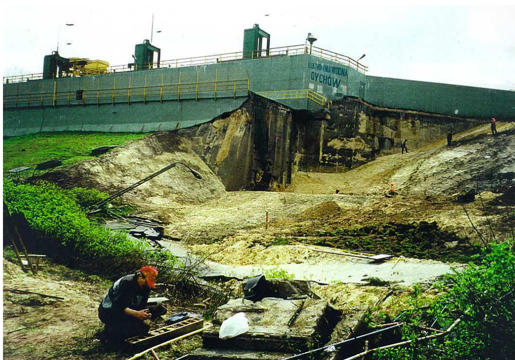
Rys 1.2. Widok na osuwisko z podnóża skarpy, w głębi ujęcie wody do elektrowni
