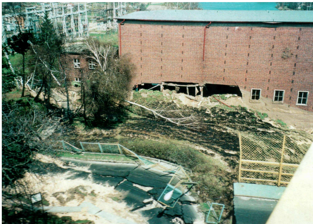
Rys 1.1. Widok na osuwisko z korony skarpy, w głębi uszkodzony budynek elektrowni
