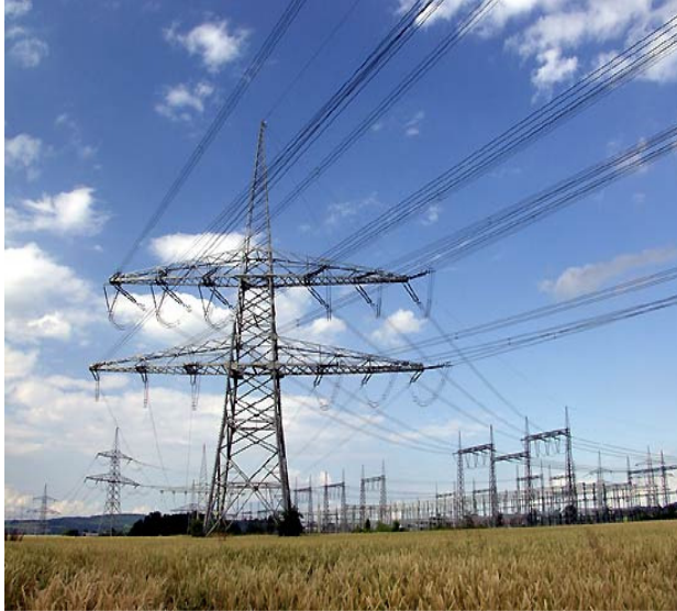
Rys. 10.5.1. Linie wysokiego napięcia
