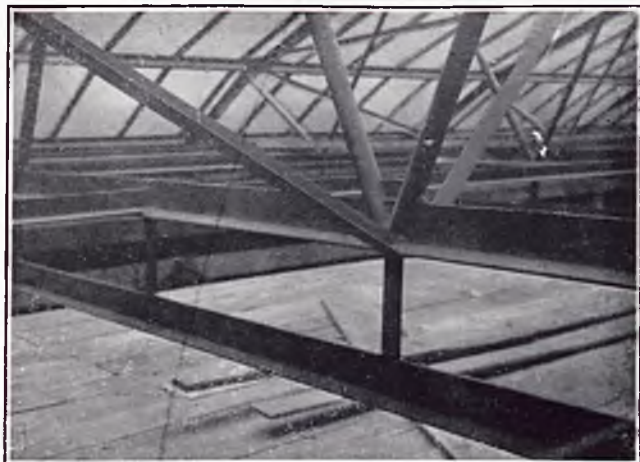
Fig. 112. — Nœud inférieur d'une ferme et la suspension d'une poutre en T du plafond.
