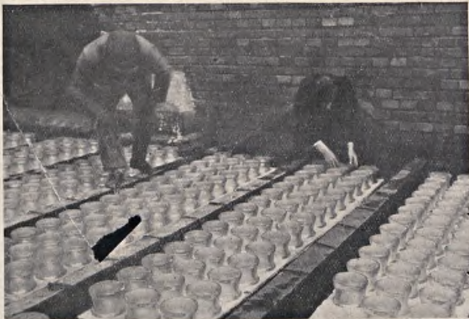
Fig. 24. Układanie przyzm szklanych stropu piwnicznego pod podwórzem w Centr. Telegr. i Telef.
