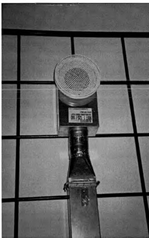
Rysunek 9.25. Element nawiewny wraz ze skrzynką rozprężną podłączoną do układu kanałów nawiewnych.
