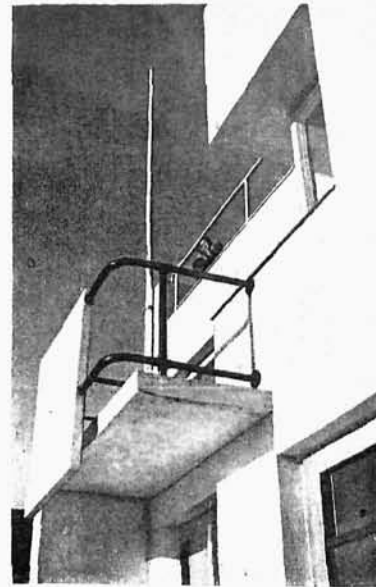
Balkon. Płyta wisząca betonowa na słupce. Barjera z rur gazo- wych, polerowana i malowana lakierem przezroczystym.
