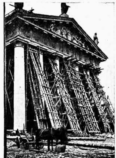
17. Ogólny widok stęplowania zabezpieczającego portyk przy rąbaniu szybków w fundamencie i podziemiu kolumn.
