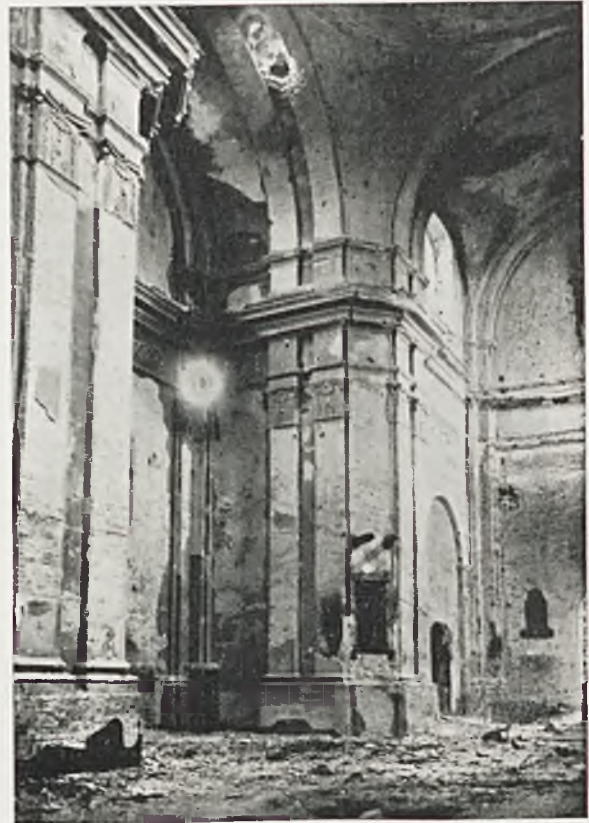
Ryc. 239. Sieniawa. Kościół paraf. po zniszczeniu.
