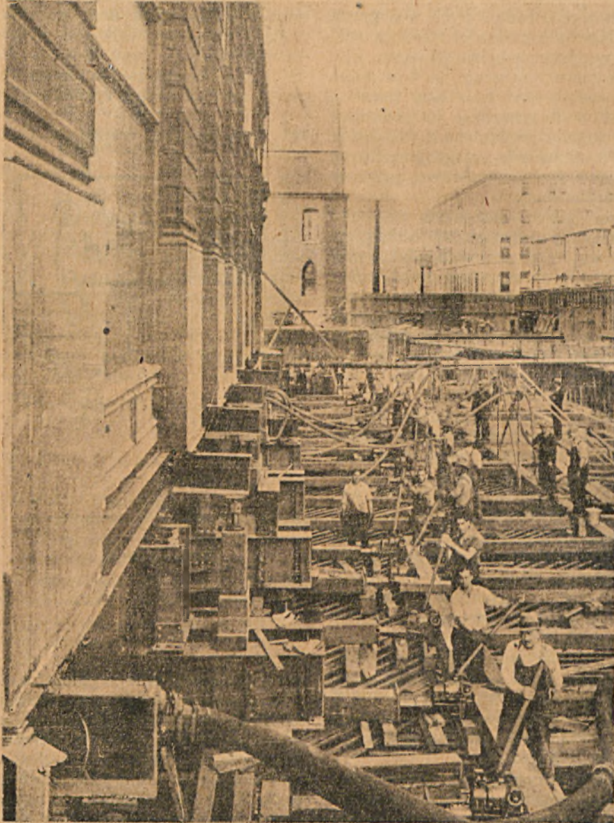
Rys. 1. 18-tu ludzi przesuwają dźwigniami 8-io piętrowy budynek centrali telefonicznej o wadze 11000 ton.
